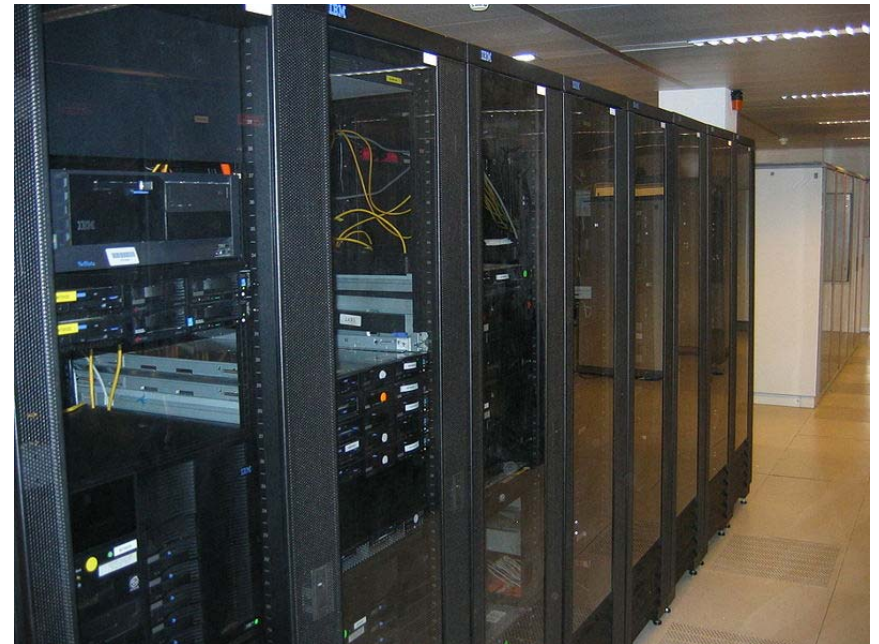
Un centro de datos donde se pueden ver varios racks .
